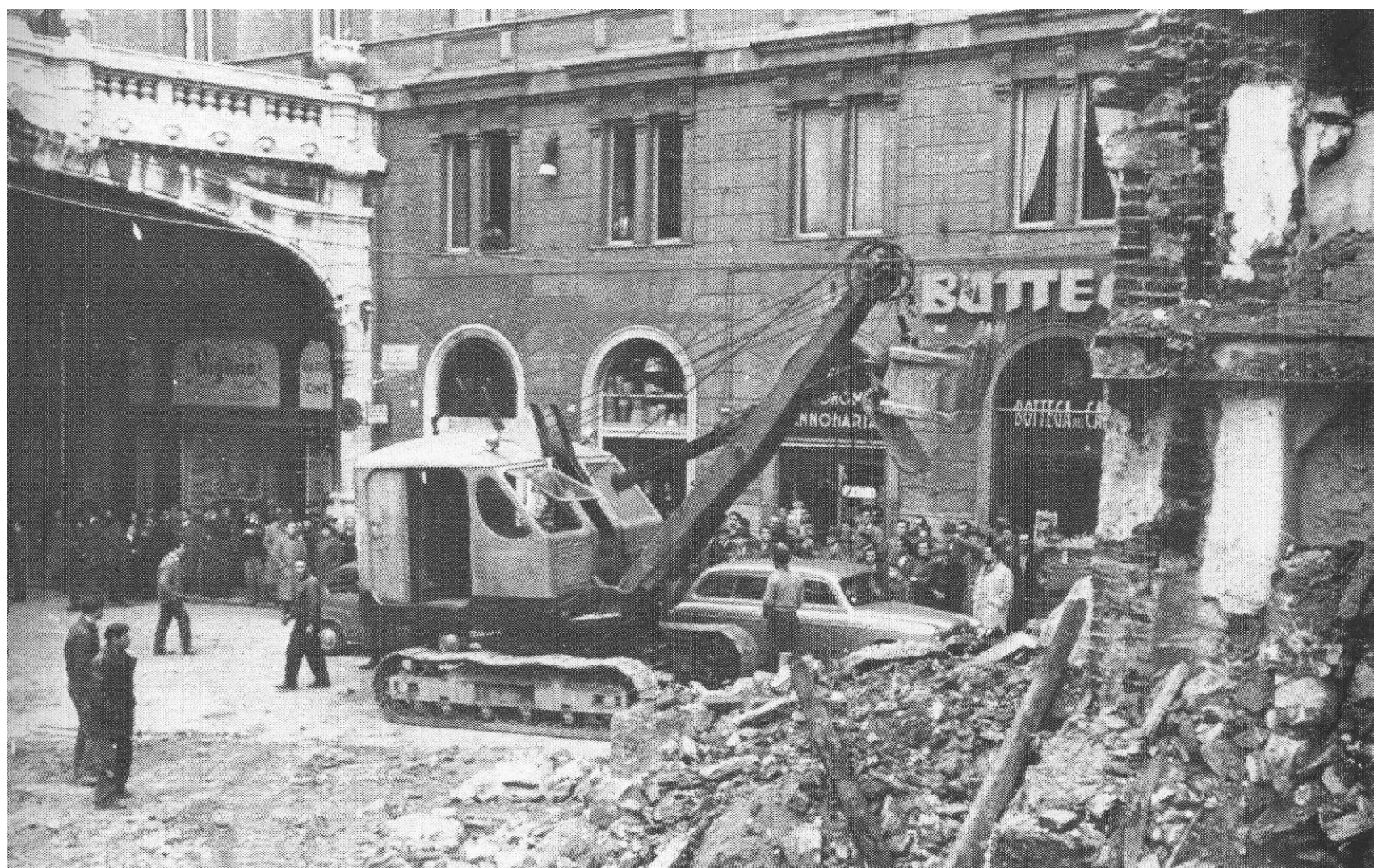
Inizio dei lavori di demolizione di Piccapietra con l'ingresso dei mezzi da via XII Ottobre (1951)
